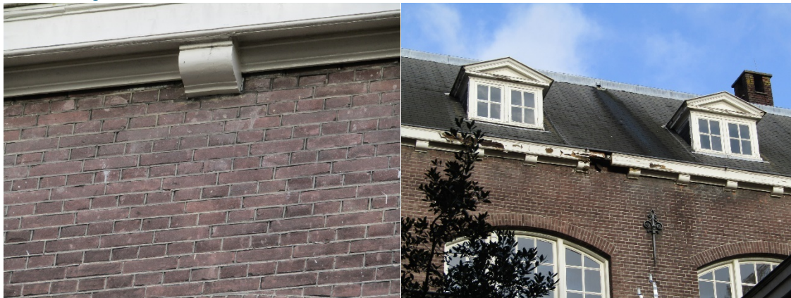
Figuur 4-1. Potentiele locaties voor verblijfplaatsen van vleermuizen. Links: mogelijkheid voor vleermuizen achter de daklijsten, rechts: scheuren en defecten in de daklijst die mogelijk toegang bieden aan gebouwbewonende vleermuissoorten.
