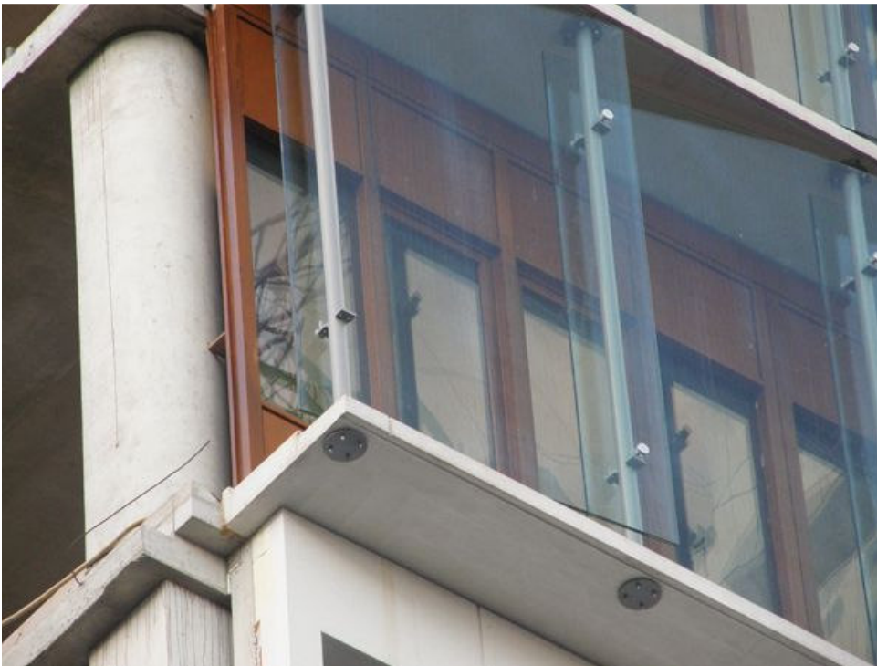
Foto 5: Nieuwbouw Erasmus MC Rotterdam. Afgeschermd gevel met de afscherming zo geplaatst dat het geluid voldoende wordt geweerd en er toch sprake is van natuurlijke ventilatie na het openen van een achtergelegen raam.
