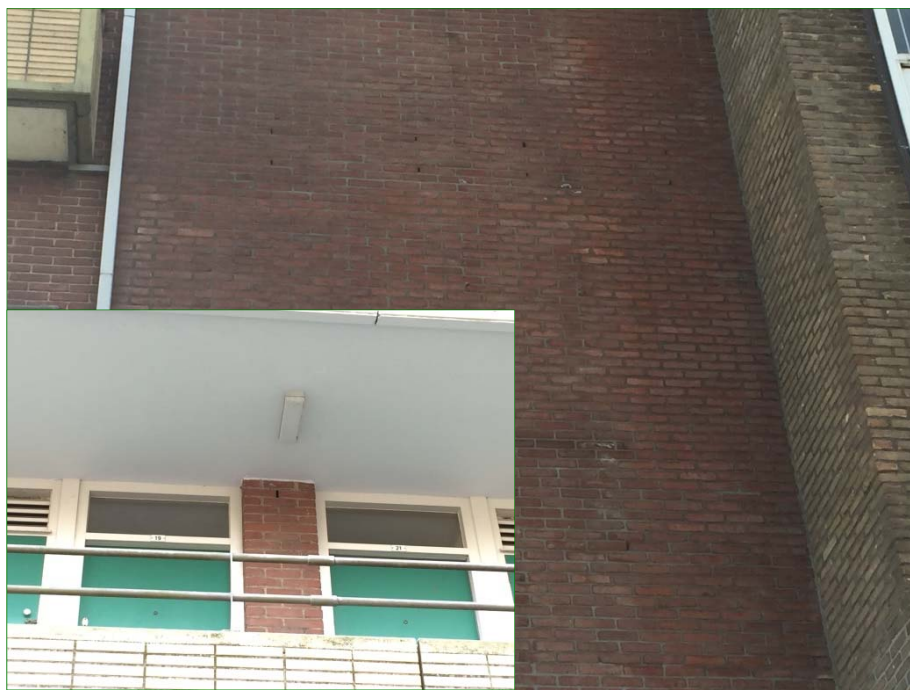
Diverse gaten zijn aanwezig in de stenen muren.
