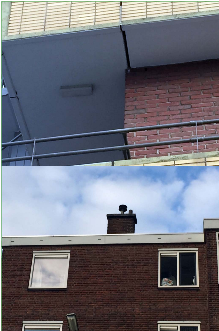
Spleten tussen de balkons (boven) en spleten in de houtlijst van het dak (onder). Deze gaten kunnen toegang geven tot holtes die geschikt zijn voor vleermuizen.
