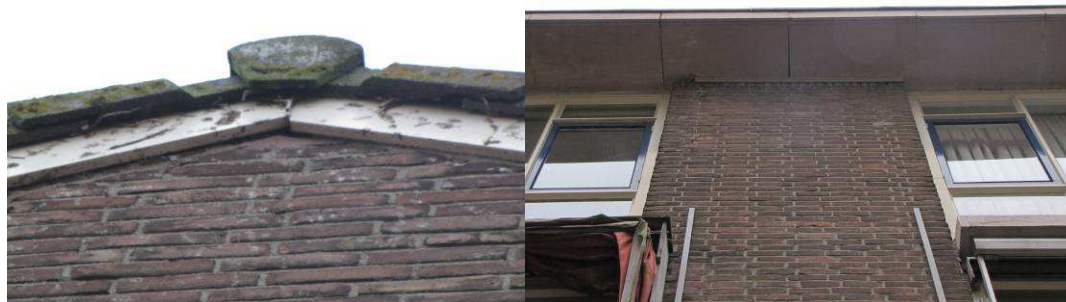
Figuur 2.3 Gaten en scheuren met potentiële verblijflocaaties voor vleermuizen, Huismus en Gierzwaluw in het plangebied (foto links: nok van dak van gebouw aan de Hendrik Casimirstraat . Foto rechts genomen ter hoogte van de Prof. Telderslaan nummer 53-63)
