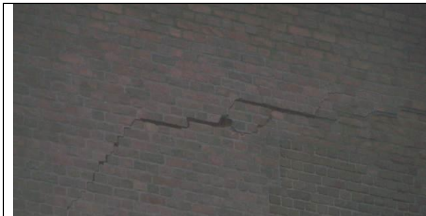
Foto 7: scheuren in bakstenen gevels
