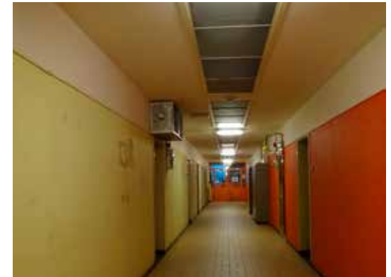
Gang op de begane grond, de daklichten functioneren niet meer vanwege een uitbouw op de verdieping erboven
