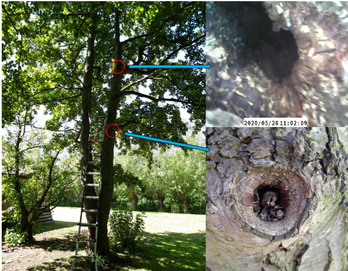
Figuur 2. De zwarte els met twee boomholtes. De onderste holte is geen holte. De bovenste holte is circa 5 cm diep en niet naar boven ingerot.
