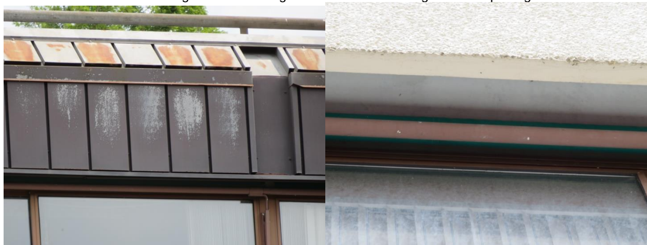
Afbeelding 8: Detailfoto's dak en aansluiting kozijnen op gevel van gebouw 1. Er zijn geen kieren aanwezig tussen de betonnen gevel en de kozijnen.
