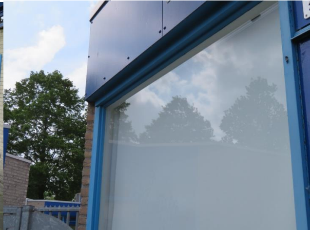
Afbeelding 8: Geen ruimte tussen trespa en kozijn.
