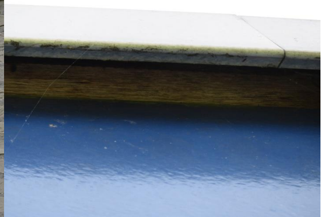
Afbeelding 6: Geen ruimte tussen daklijst en gevel.
