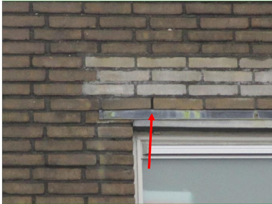
Open stootvoeg met mogelijke toegang tot voor vleermuis geschikte achterliggende ruimte in de voorgevel van de bebouwing van Roerdomplaan 86.
