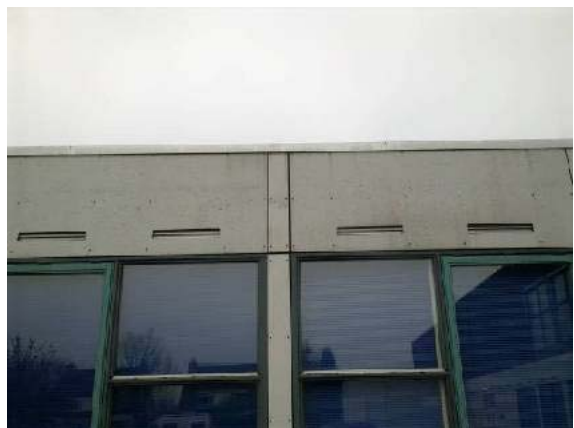
Foto 12: beplating aan de achterzijde van de huisartsenpraktijk; naden en daklijst zijn goed afgedicht en de ventilatie-openingen zijn niet groot genoeg voor vlemuizen
