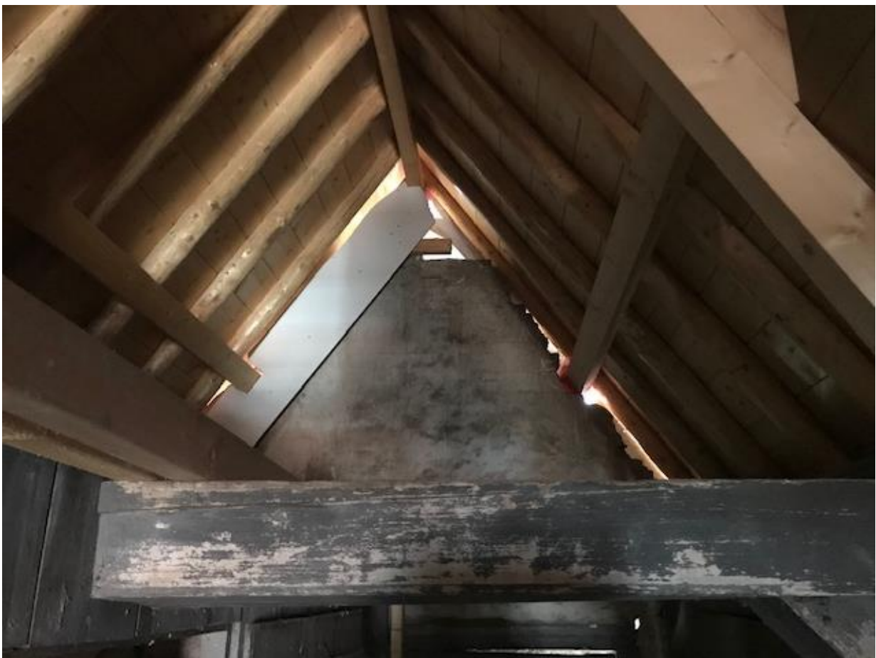
Figuur 6. Situatie kopgevel inpandig bekeken (met tochtgaten)
