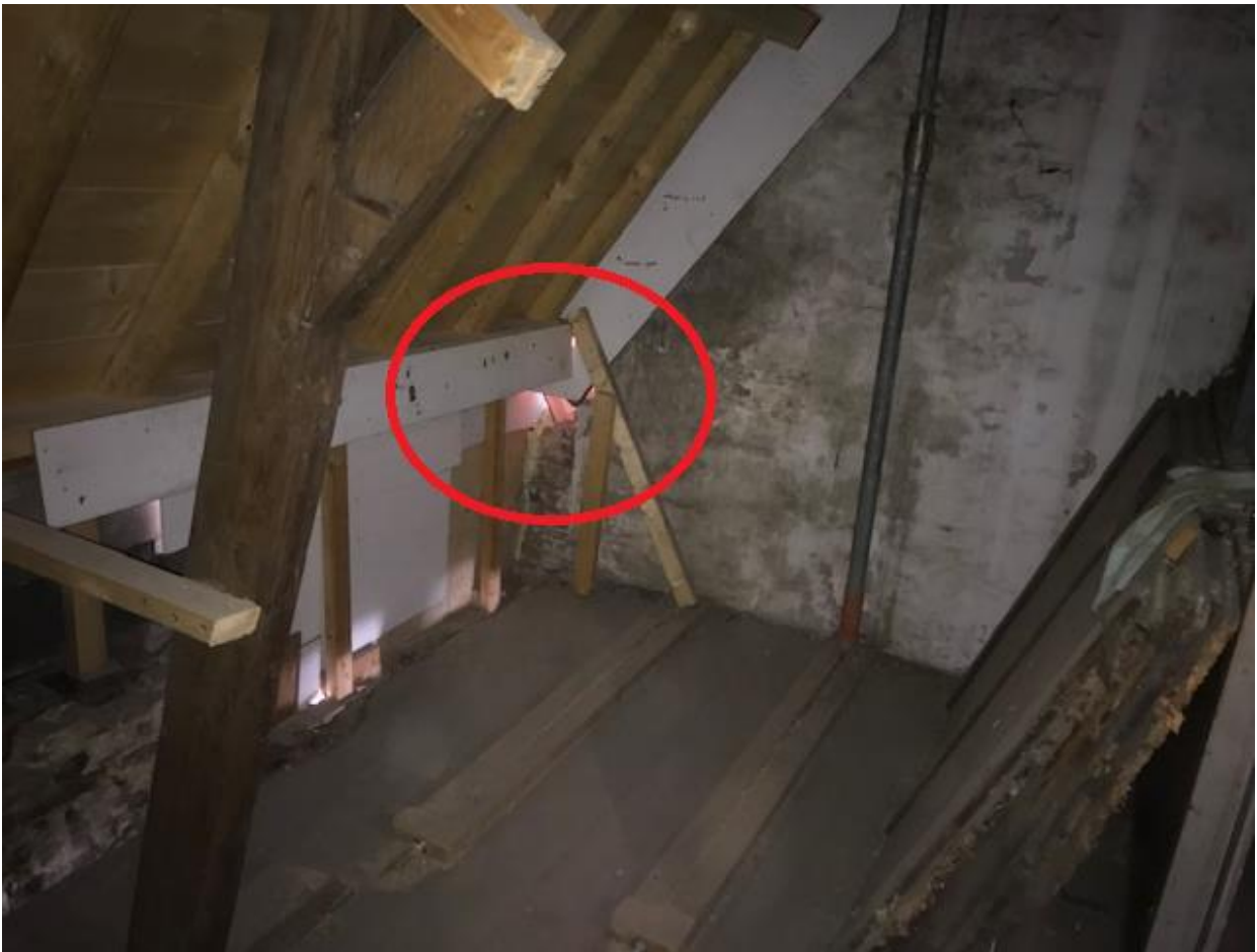
Figuur 5. Situatie kopgevel inpandig bekeken (met tochtgaten)
