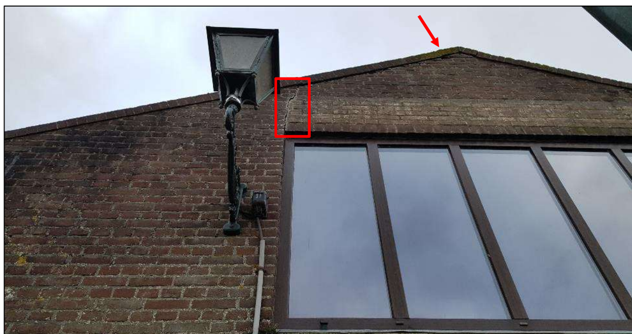
Afbeelding 3: een scheur (rode rechthoek) en een gat in de muur (rode pijl), beide geschikt als verblijfplaats voor vleermuizen.
