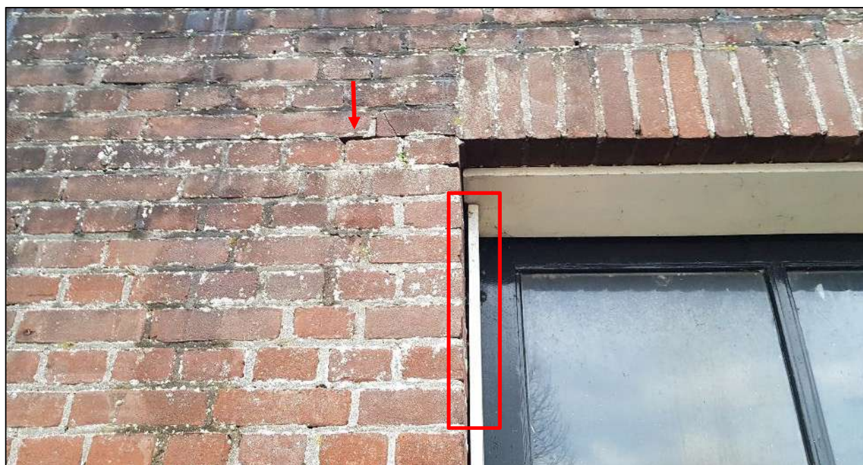
Afbeelding 2: een kier langs het kozijn (rode rechthoek) en een scheur in de muur (rode pijl), beide geschikt als verblijfplaats voor vleermuizen.
