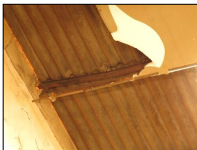
Figuur 7. Deel van het dak waar isolatiemateriaal ontbreekt, waardoor ruimte tussen de golfplaten en isolatie vanuit de binnenkant van de loods bereikbaar wordt voor o.a. vleermuizen en vogels.
