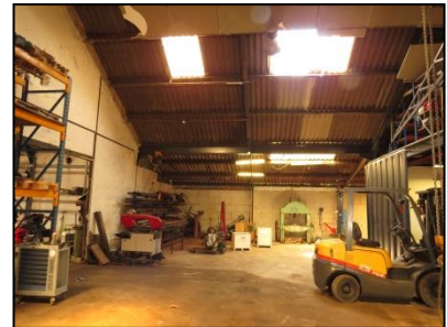
Figuur 5. Binnenkant van het dak van de loods, met in beeld een deel waar geen isolatieplaten meer aanwezig zijn.
