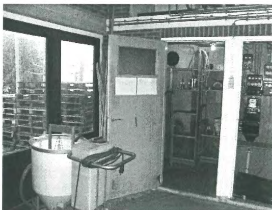
Bestrijdingsmiddelenkast in 1 e loods (betonvloer).
