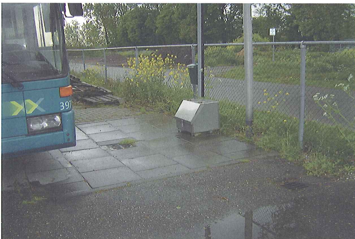
Foto 4: Ontluchtingspunt ondergrondse dieseltank
