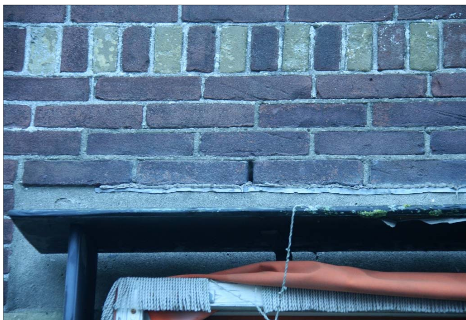
Het enige aanwezige ventilatiegat boven een kozijn in de woning op nr 135.
