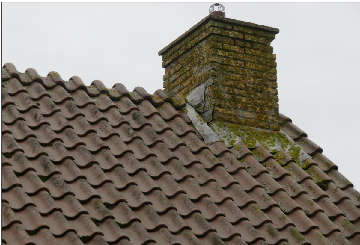
Afb 12: Ook bij huisnummer 2 liggen de pannen strak. Aansluitingen bij de schoorsteen zijn dicht
