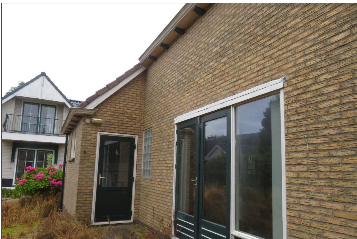
Afb 16: Geen openingen in metselwerk
