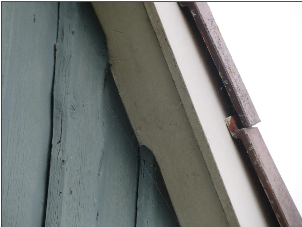
Afb 15: Geen openinge tussen betimmering. Houten plank te glad voor vleermuizen om onder de pannen te kunnen komen
