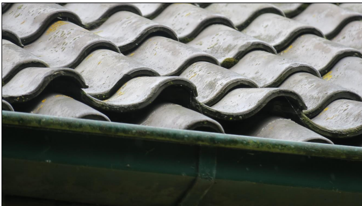
Figuur 3.4 Er bestaat ruimte tussen de dakpannen van de woning, welke huismussen toegang verlenen tot de ruimte tussen de dakpannen en het dakbeschoot.
