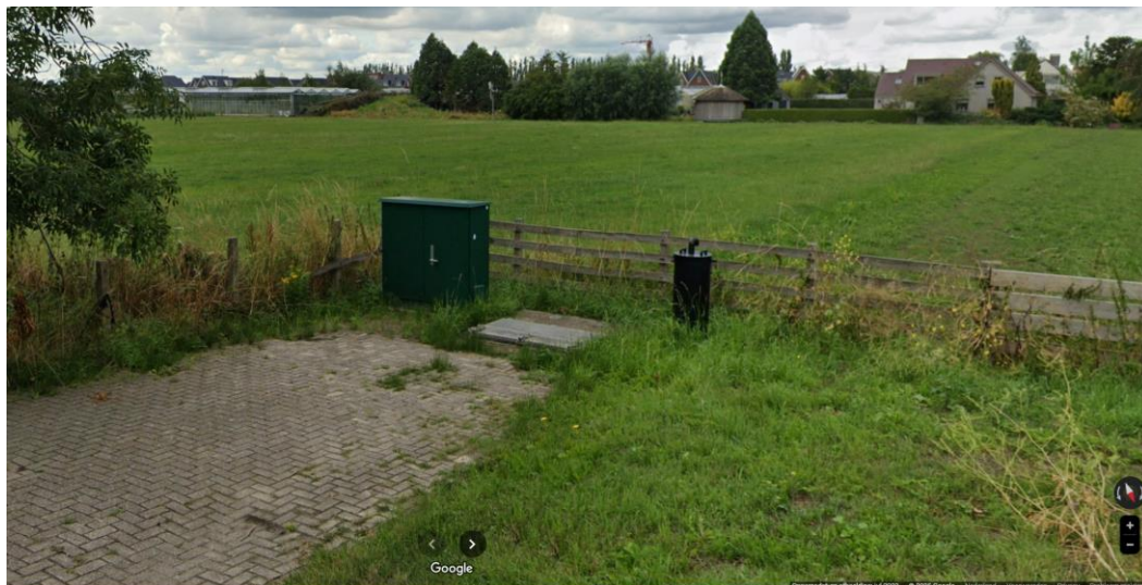
f 3.3 Rioolgemaal Noorderdracht, juli 2023
