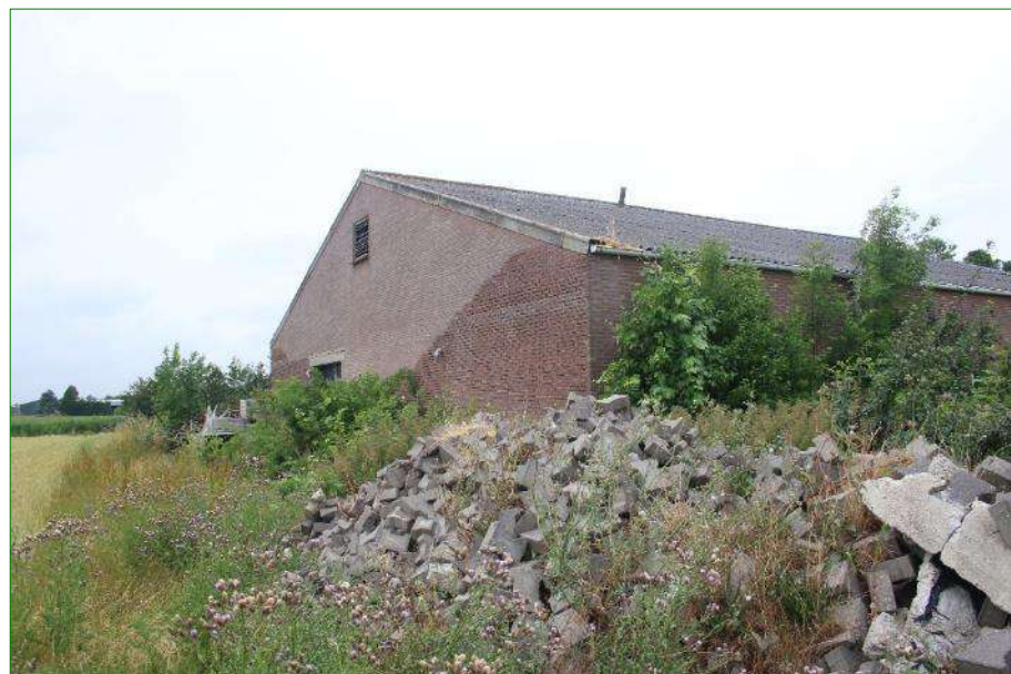
Zuidzijde van de opslagloods met puinstapel op de voorgrond.
