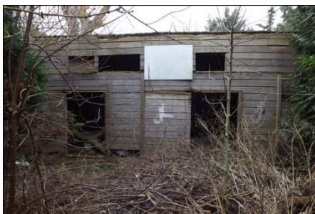
Te slopen bebouwing
