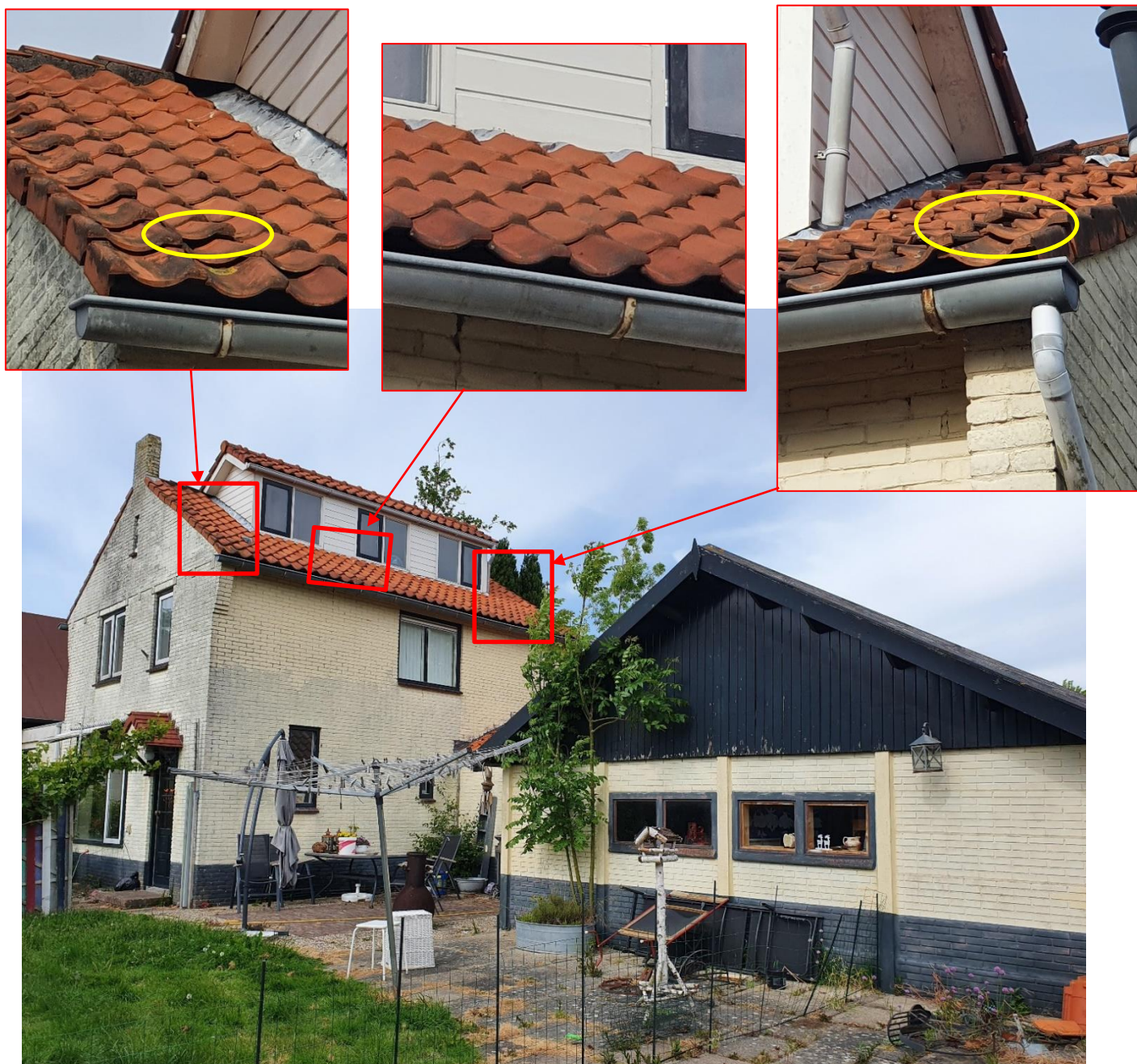
Figuur 19: Zuidkant van dak van de woning met aan de linker- en rechterkant van het dakkapel enkele dakpannen die niet meer volledig op elkaar aansloten en daardoor spleten lieten zien.
