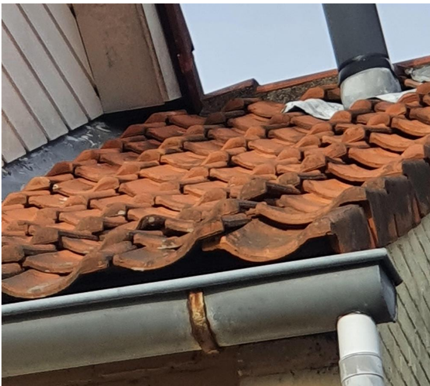
Figuur 22: Zuidelijk deel van het dak van de woning heeft enkele scheven dakpannen, waar vleermuizen onder kunnen kruipen.
