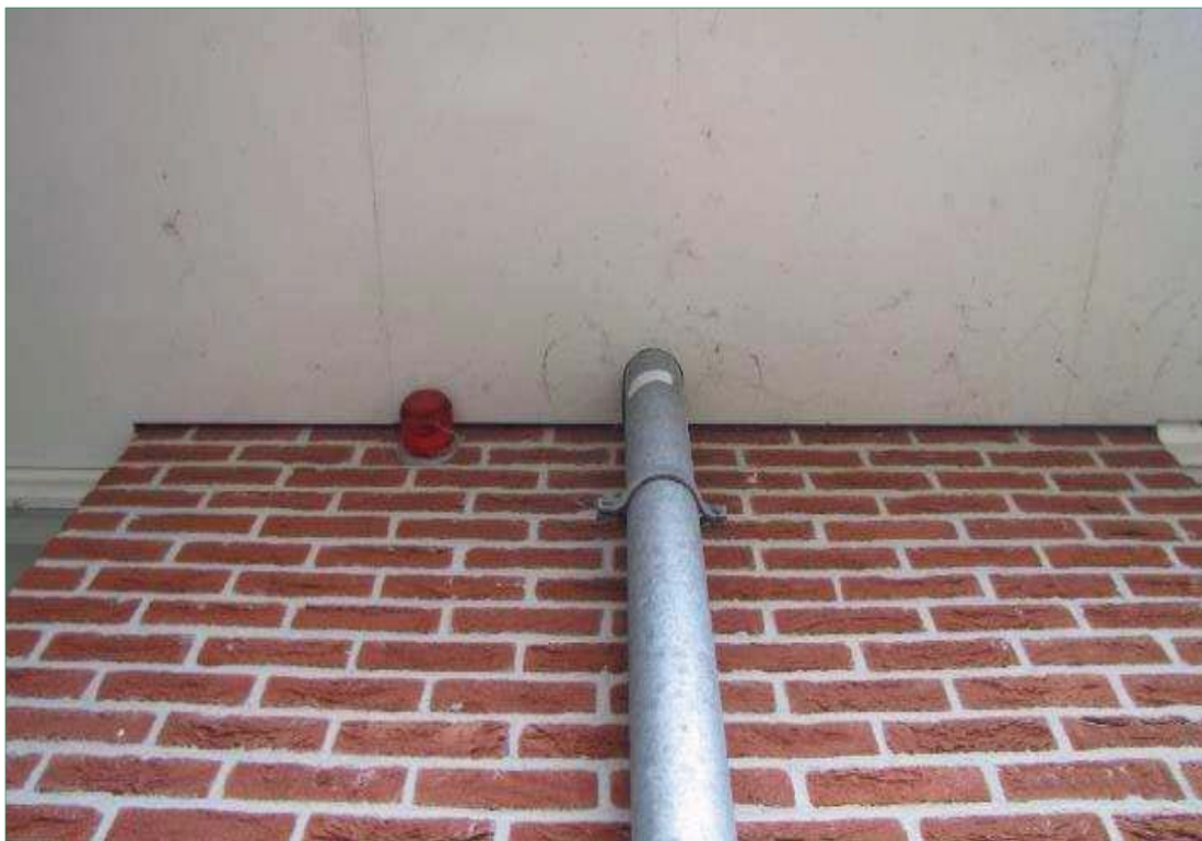
Kieren tussen houtlijst en stenen muur geven mogelijk toegang aan tot voor vleermuizen geschikte holtes.
