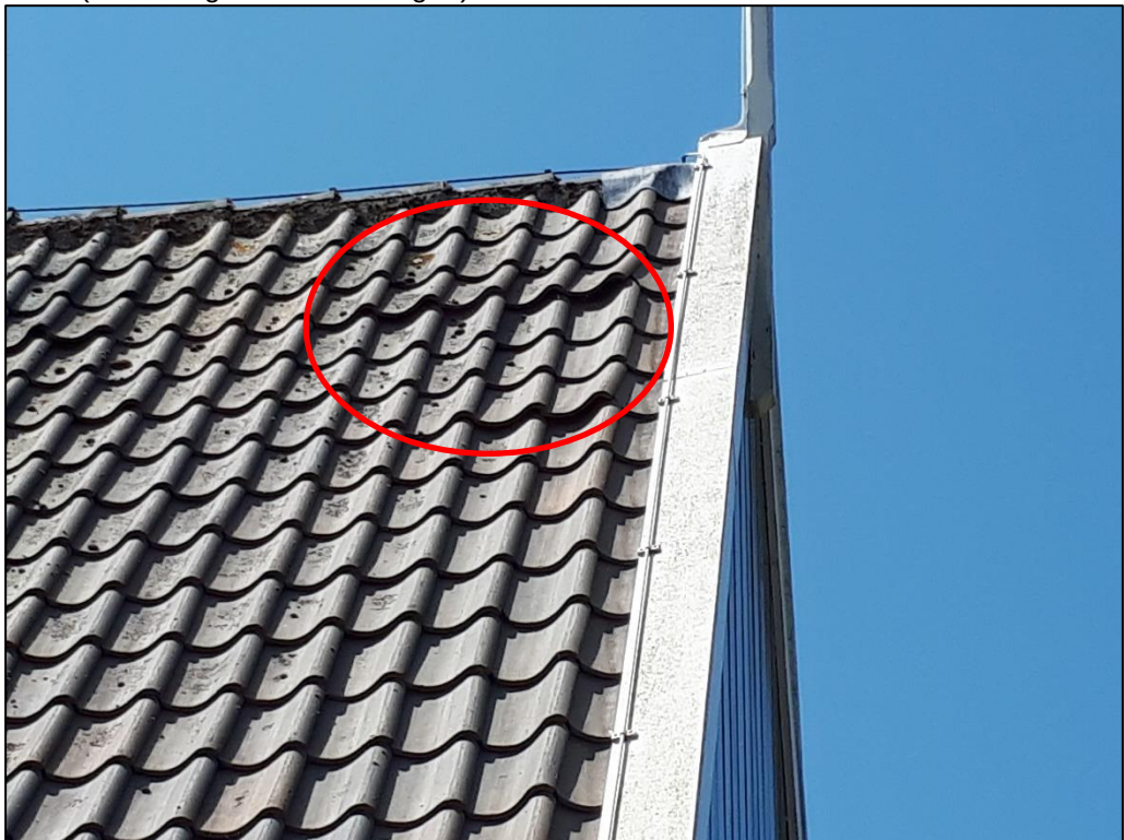
Scheefliggende dakpannen (rood omcirkeld) op het complex.
