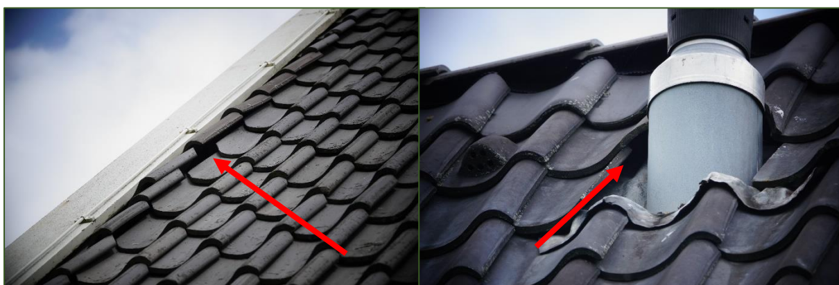
Figuur 6 Holte onder scheef liggende dakpan (links) en ruimte tussen dakpan en schoorsteen (rechts).
