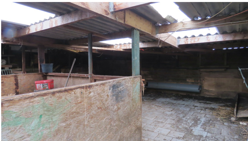
Afbeelding 12: De binnenzijde van de schuur tussen de stalen loods en zeecontainer: veel lichtinval en grote kieren onder het enkellaags golfplaten dakvlak. Ongeschikt als vleermuisverblijfplaats.
