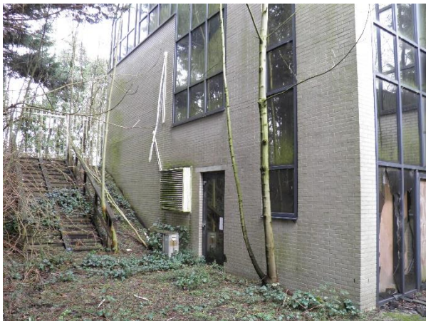
Figuur 9. Detailopname van de gevel van het kantoorgedeelte met onderaan de muur open stootvoegen. Links in beeld de grote coniferen.
