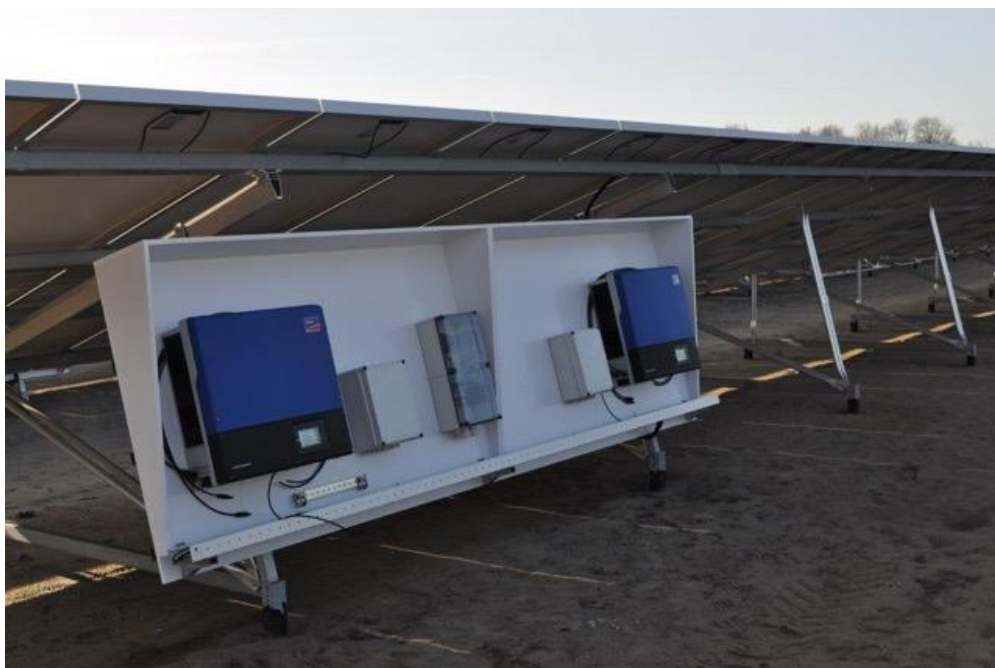
Figuur 7 Fotobeeld constructie met zonnepanelen
