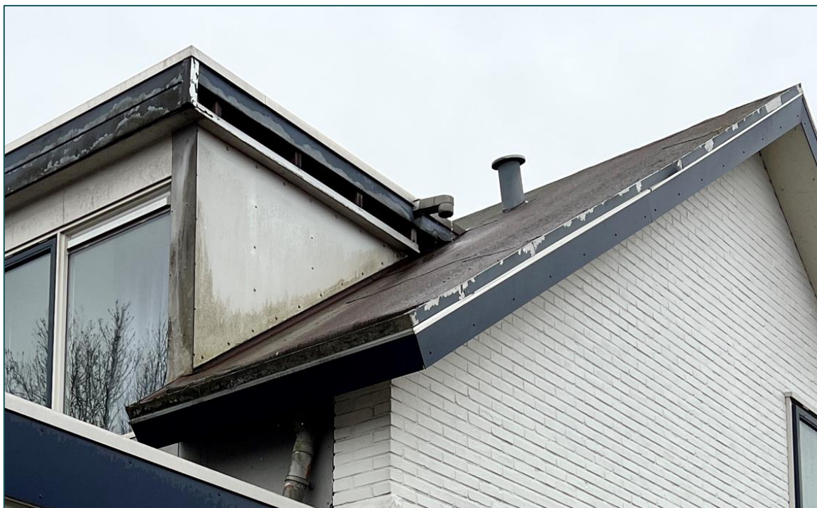
Figuur 2 De opening aan het dakkapel op de noordzijde van het zadeldak is een grote opening aanwezig. Gezien de grootte is de mogelijke ruimte erachter ongeschikt voor vleermuizen en gezien de opening makkelijk toegankelijk is voor roofdieren is het ongeschikt als nestlocatie voor bijvoorbeeld de huismus.
