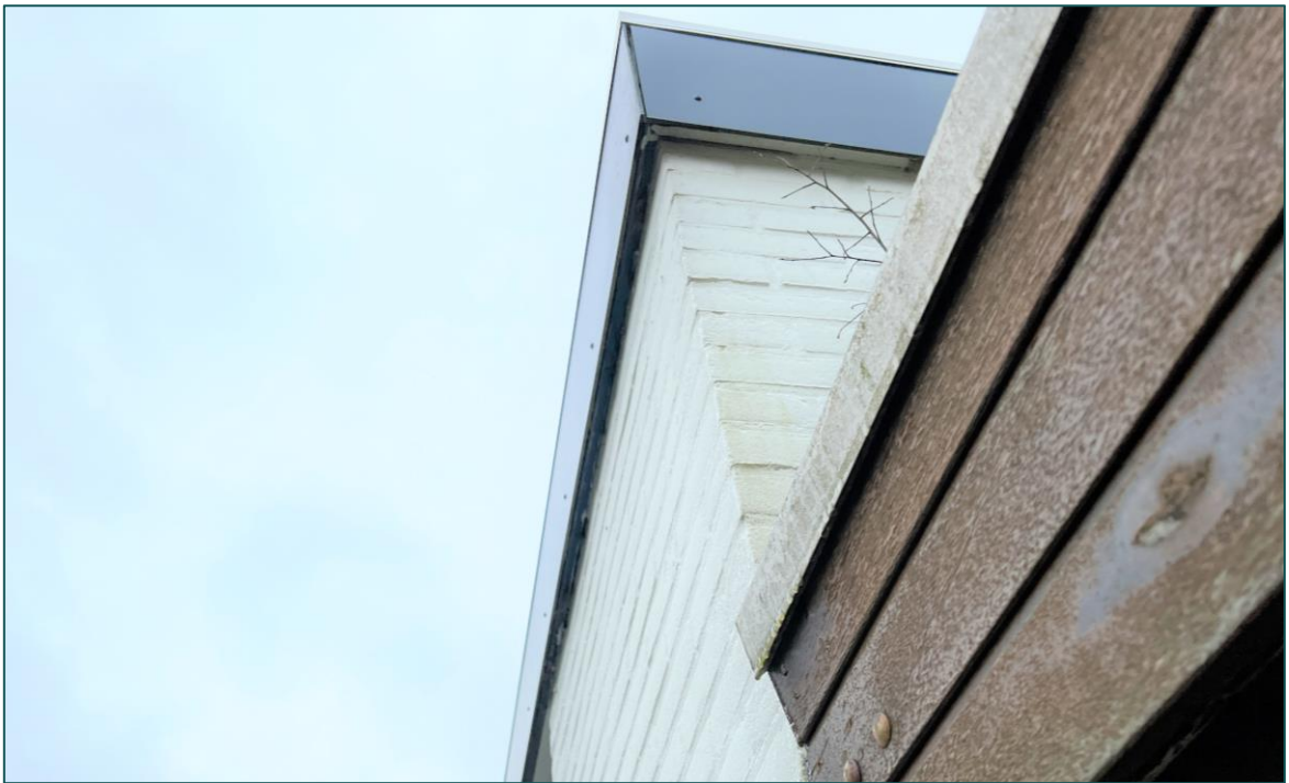
Figuur 3 De daklijsten en boeiborden sluiten strak aan waardoor geen openingen van voldoende grootte aanwezig zijn waar vleermuizen gebruik van kunnen maken.
