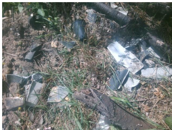
Foto 4: Asbestverdachte materialen ter plaatse van boring 11/gat 11.
