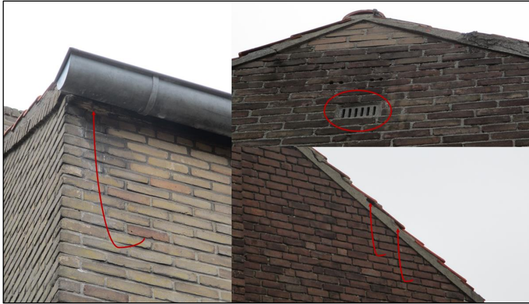
Figuur 1.3 Middels toegankelijke dakgoten, kierende kantpannen, de ruimte tussen dakgoot en gevel en open stootvoegen kunnen huismussen, gierzwaluwen en vleermuizen toegang krijgen tot potentiële nesten en verblijfplaatsen in de woningen.
