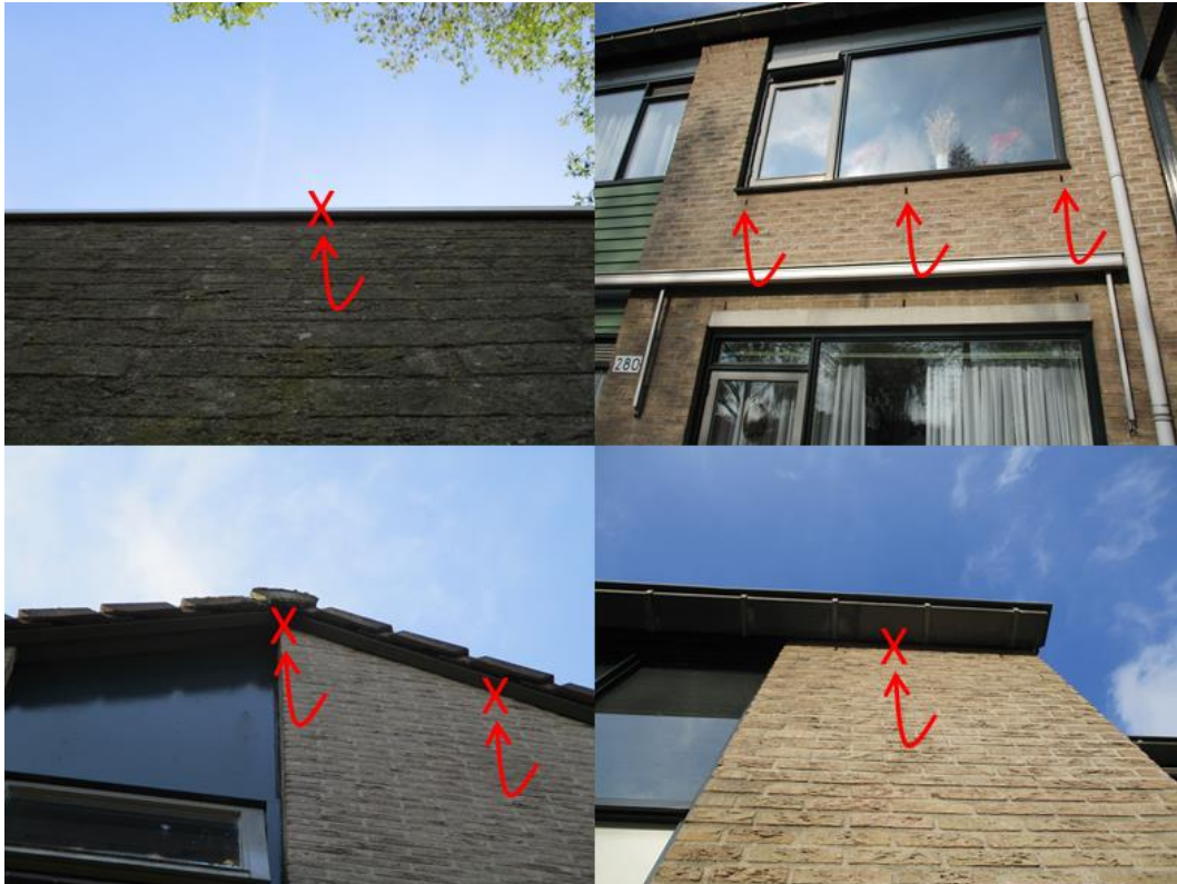
Figuur 24 Voorbeelden van potentiële invliegopeningen voor vleermuizen. De potentie bestaat alleen uit de aanwezigheid van een grote hoeveelheid open stootvoegen. De kantpannen, aluminium daklijst (berging) en onder de dakgoot zijn ontoegankelijk voor vleermuizen en gierzwaluwen. De onderste rij dakpannen zijn toegankelijk voor huismussen.
