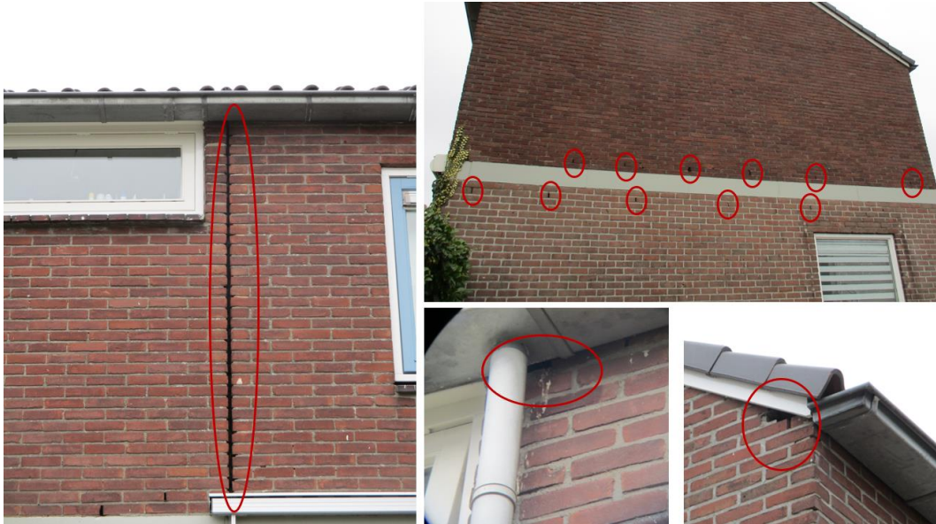
Figuur 13 Voorbeelden van potentiële invliegopeningen voor vleermuizen, gierzwaluwen, daarnaast zijn de onderste rij dakpannen toegankelijk voor huismussen in de woningen in de Fruitwijk te Barendrecht. Tevens wijzen de krijtsporen tegen de gevel op aanwezigheid van een (oud) gierzwaluwnest.
