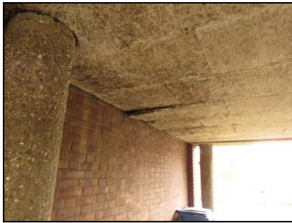
Figuur 6. Een passage onder het schoolgebouw door, met loshangende plafondplaten, eventuele verblijfplaats voor vleermuizen.
