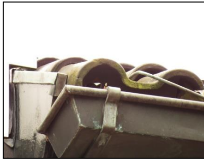
Figuur 7. Open dakpannen en takjes in de dakgoot, mogelijke indicatie voor huismusnest. Tevens zijn scheefliggende en kapotte dakpannen een geschikt broedbiotoop voor de gierzwaluw.
