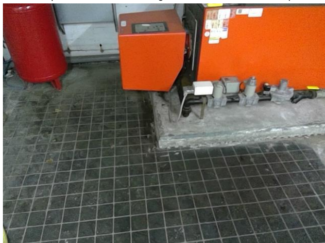
Foto 6 | Foto voor bron Pakking tussen brander en branderplaat
