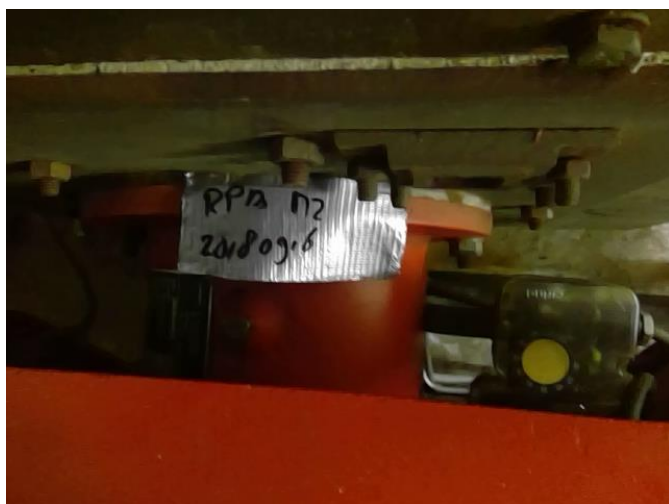
Foto 4 | Foto voor bron Pakking tussen brander en branderplaat
