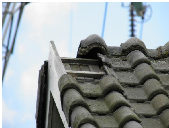
Figuur 5. Ontbrekende nokpan op de projectlocatie.
