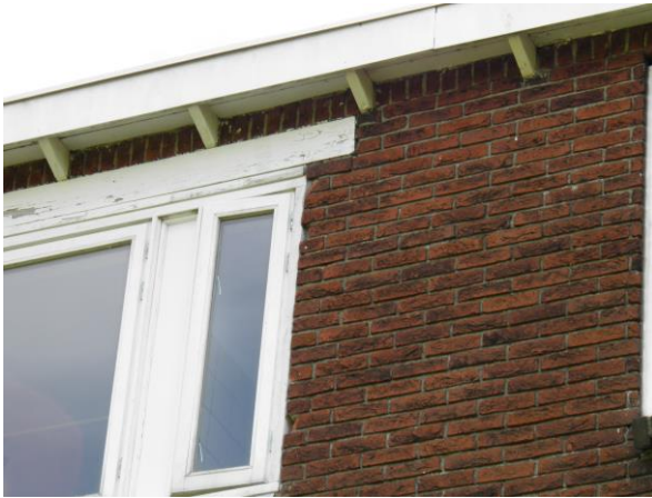
Figuur 6. In de buitenmuur ontbreken open stootvoegen.
