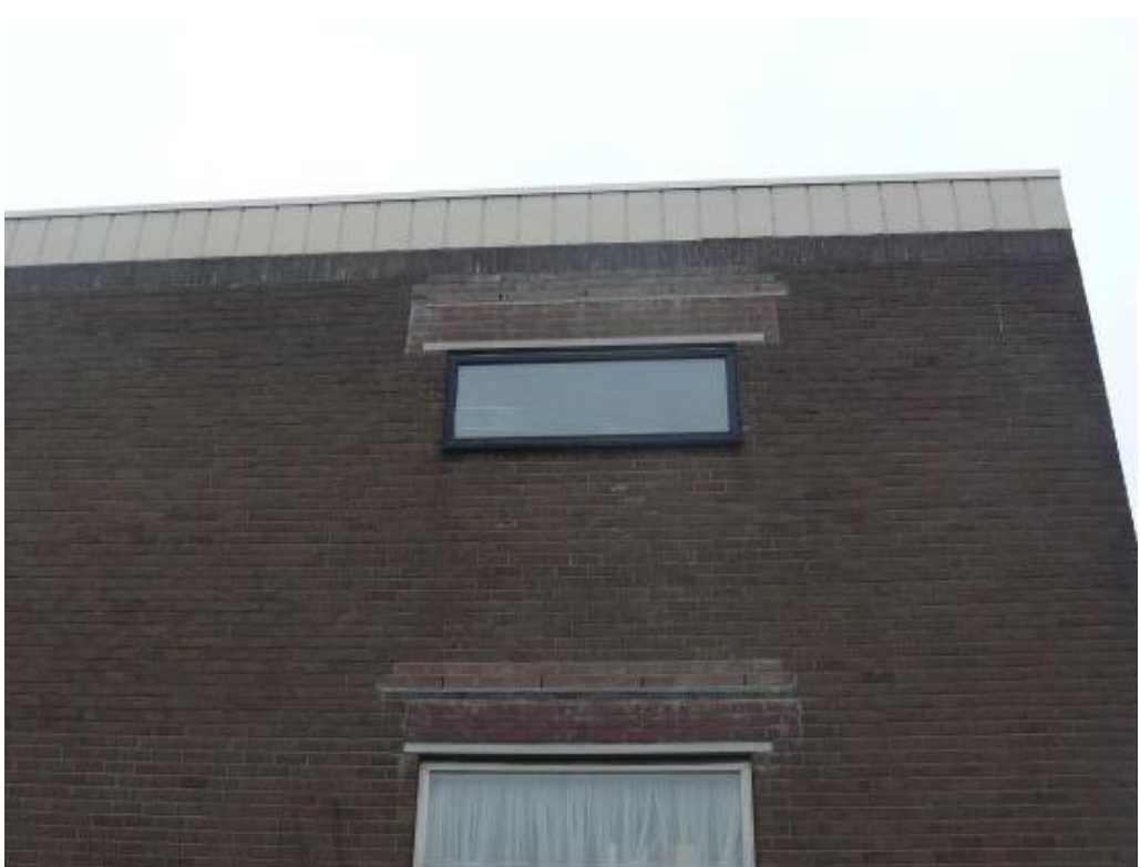
Foto 8. Open stootvoegen aan het noordelijk deel van de bebouwing.
