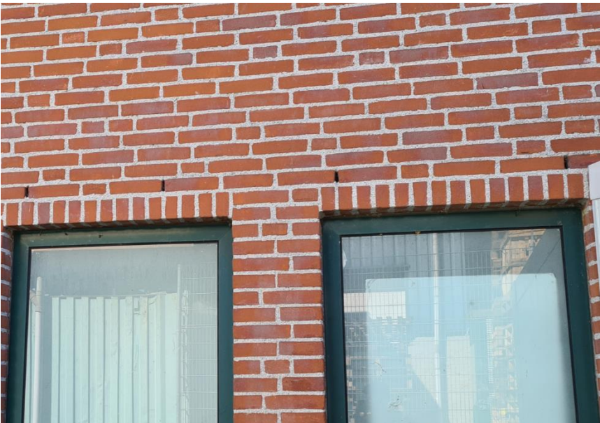
Figuur 14: Open stootvoegen boven raamkozijn bij Transportweg 20 - 46
