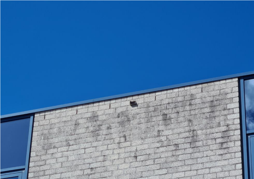
Figuur 12: Open stootvoegen bij Gebroken Meeldijk 66
