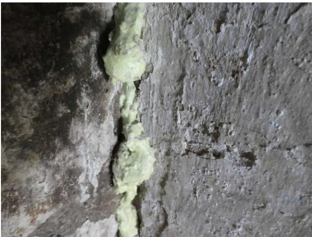
Figuur 44: In afgelopen jaren dichtgemaakte scheuren
