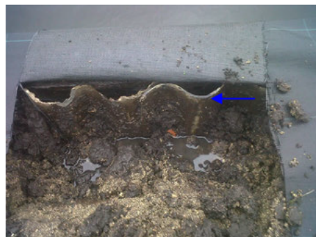
Foto 2; M1 en M2: Asbestvrije golfplaten als beschoeiing.
