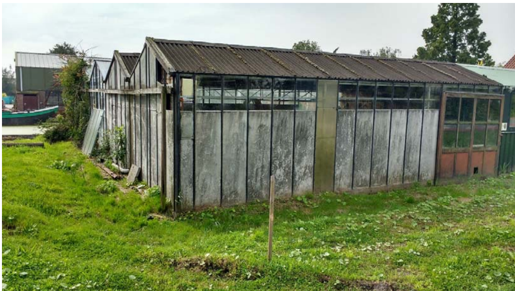
Foto 5: Asbestverdachte platen aan de zijkant van de schuur. De schuur ligt net iets lager dan het omliggende grasveld.
