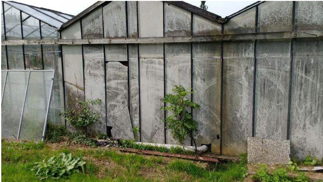
Foto 6: Niet geheel intacte asbest verdachte platen
