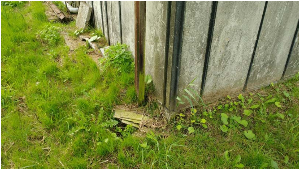
Foto 7: Resten asbest verdachte platen
