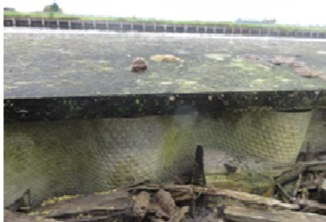
Foto 3; M1B: Asbesthoudende golfplaten als deel van de beschoeiing.
