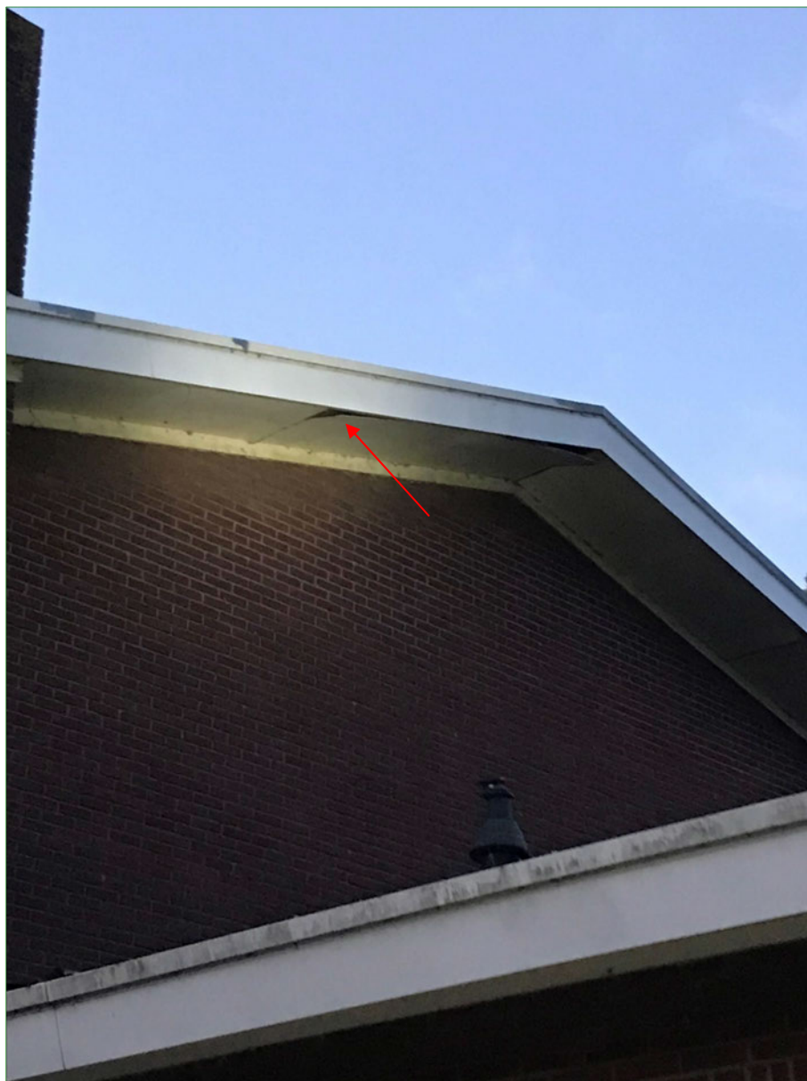
Uitvliegopening van een zomerverblijf Gewone dwergvleermuis bij een losse houten plank aan de voorgevel.
