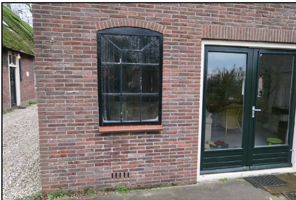
Figuur 2 De ventilatieopeningen in de spouwmuur van woning '2' bevinden zich vlak boven de grond waardoor er geen geschikt aanvliegroute voor vleermuizen aanwezig is.
