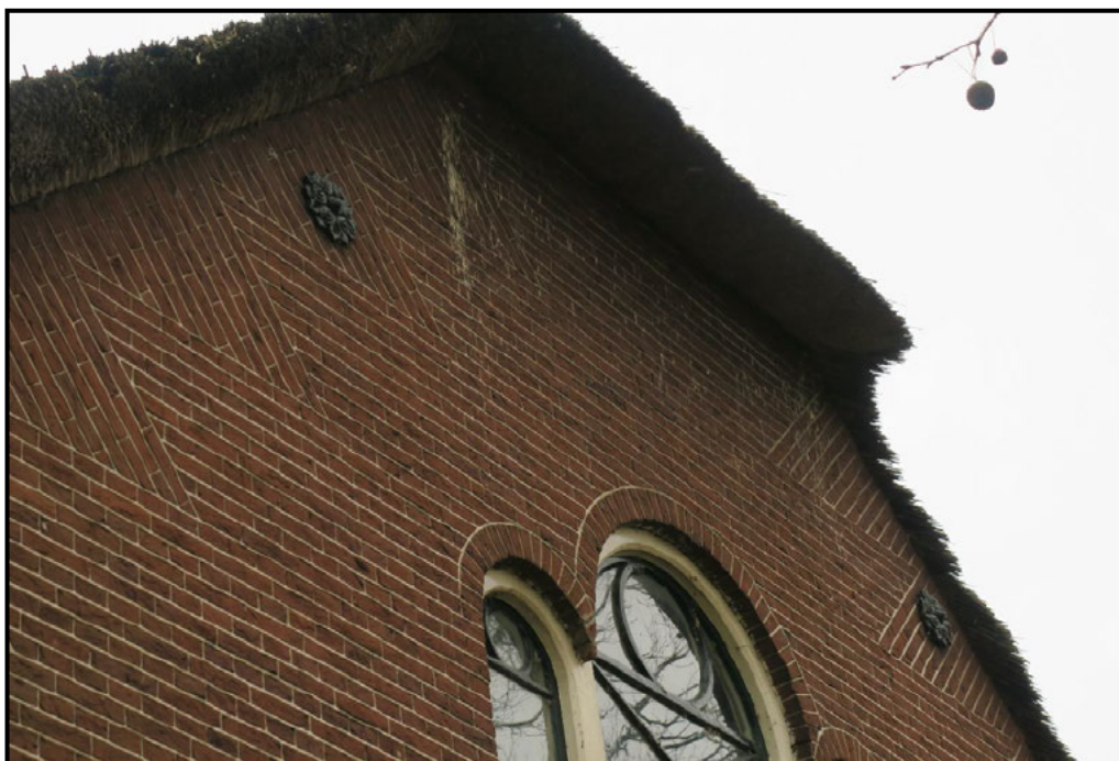
Figuur 1 Aan de noordelijke kopgevel van de boerderijwoning op de planlocatie zijn krijtsporen van spreeuwen aanwezig.
