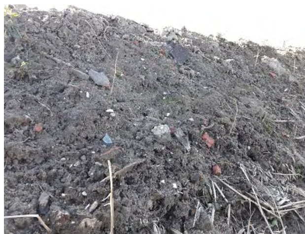
Fotonummer: 4. Zichtuiglijk veel puin in de ophogingen aangetroffen (o.a. baksteen, plastic, dakpan)
