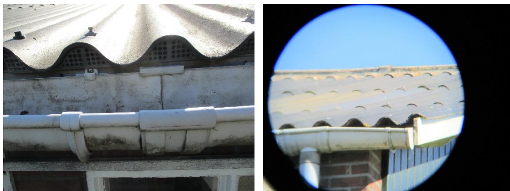
Figuur 5 Vogelwerende middelen aanwezig onder de dakranden van beide bedrijfsgebouwen.
