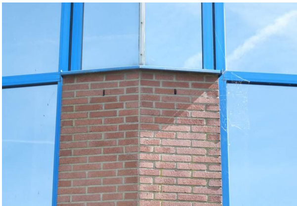
Figuur 9. Open stootvoegen aan de noordzijde van het gebouw
