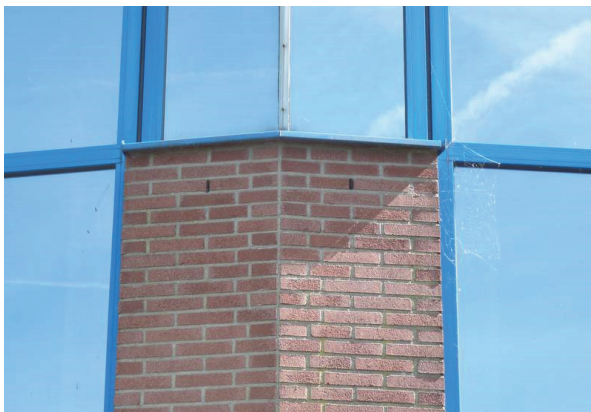
Figuur 7: Open stootvoegen in de noordzijde van het gebouw
