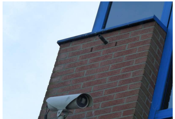
Figuur 10. Open stootvoegen aan de westzijde van het gebouw
