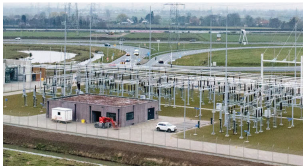
Voorbeeld van een station van TenneT met een Centraal Diensten Gebouw en een schakeltuin. Dit is geen exacte verbeelding van het nieuwe 150/50/10kV station.
