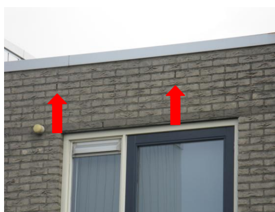
Foto 5: Spouwgaten in woonhuis met nr. 125
