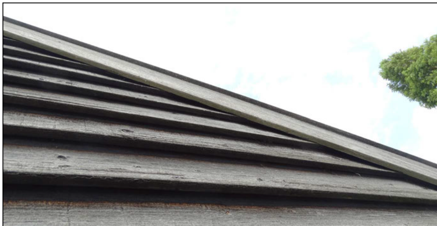
Figuur: naast de ruimte tussen de dakpannen is er ook ruimte tussen de planken aan de kopse kanten van het gebouw waar vleermuizen tussen kunnen kruipen.
