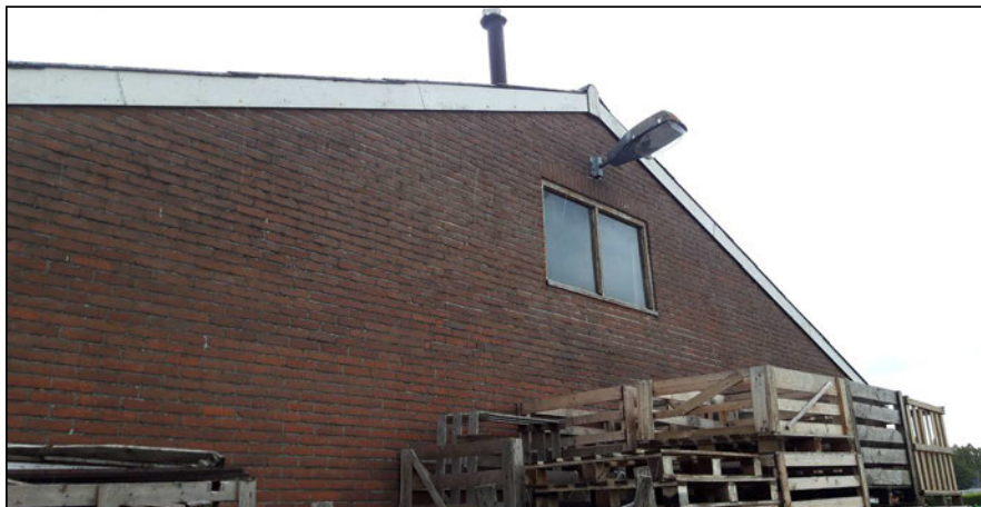
Figuur: aan de voor en achterzijde van de schuur zijn op sommige plekken spleten waar dwergvleermuizen tussen kunnen kruipen. Ook staan er pallets waar een witte kwikstaart tussen zou kunnen broeden.
