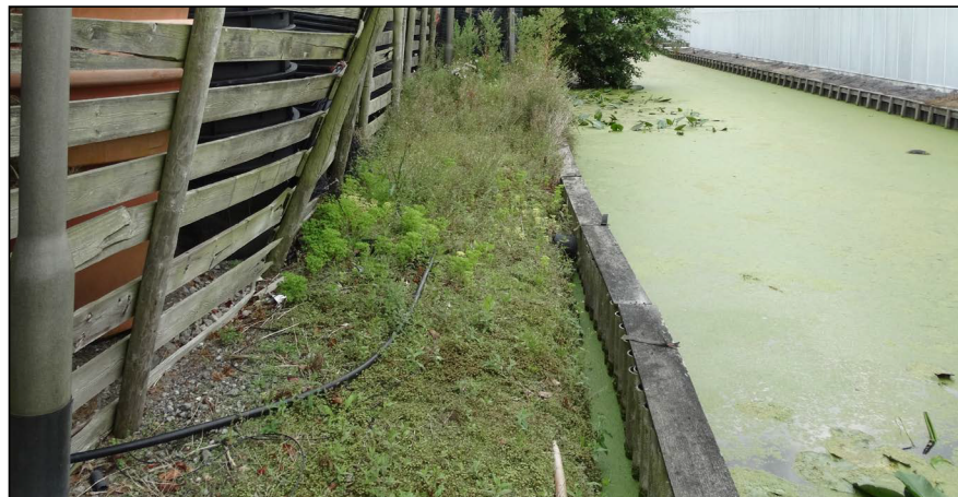
Figuur: de schoeiing is hoog en ongeschikt voor ringslang en waterspitsmuis wegens het ontbreken van dekking. De sloot is geschikt voor platte schijfhoren, maar er wordt niet in het water gewerkt.
