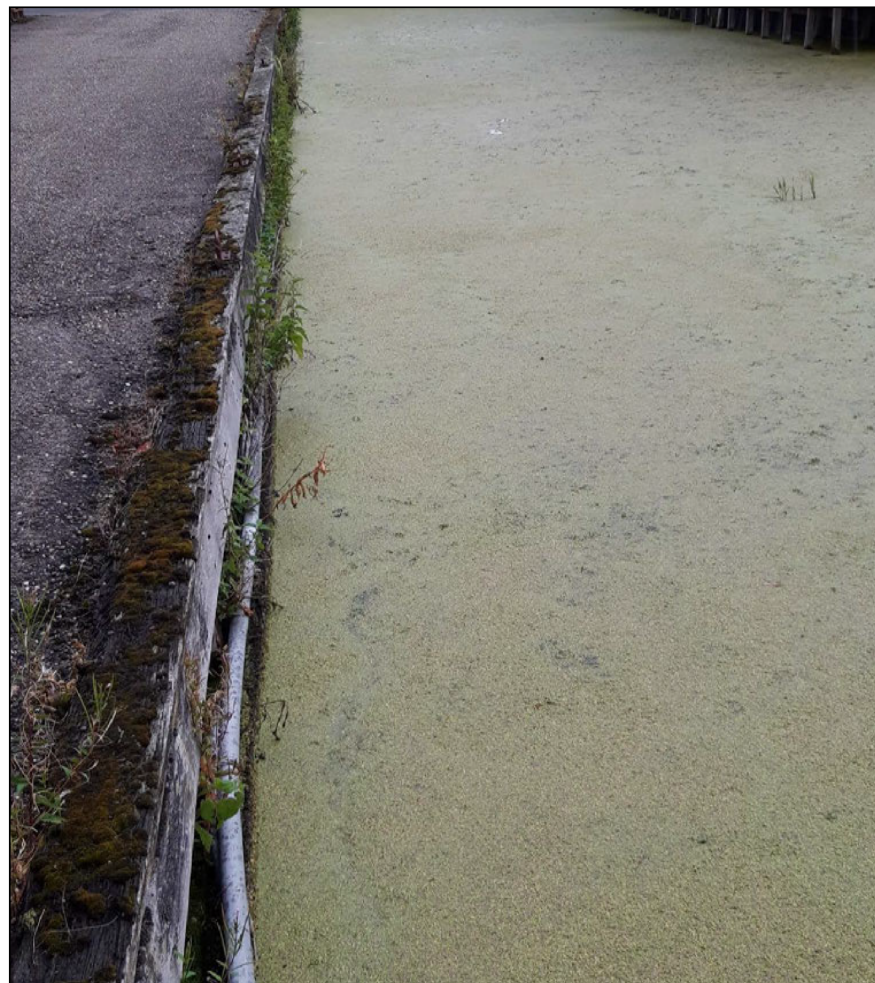
Figuur: de schoeiing is hoog en ongeschikt voor ringslang en waterspitsmuis, omdat er geen dekking is. wegens het ontbreken van helofyten en drijfplanten is de sloot ook ongeschikt voor platte schijfhoren.
