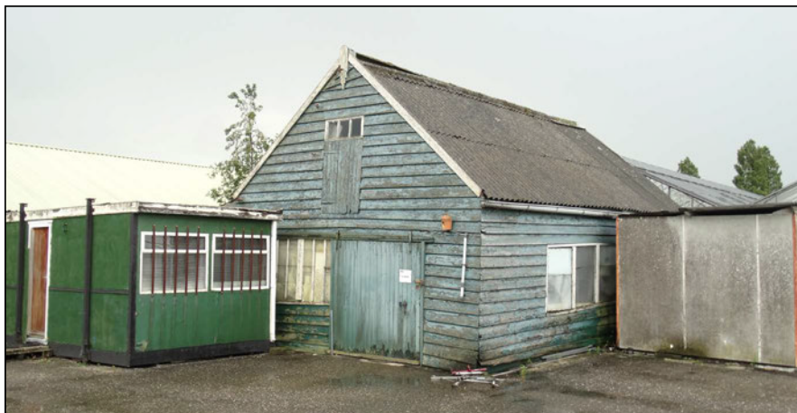
Figuur: de schuur op het terrein heeft geen dakpannen en de randen zijn ongeschikt voor vleermuizen om onder te kruipen.
