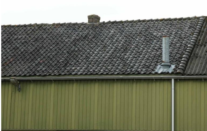
Figuur 8: Deels dakpannen dak loods (zuidwest)
